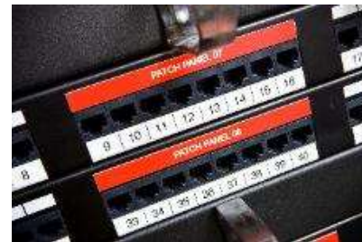
Verteiler und Steckfelder
