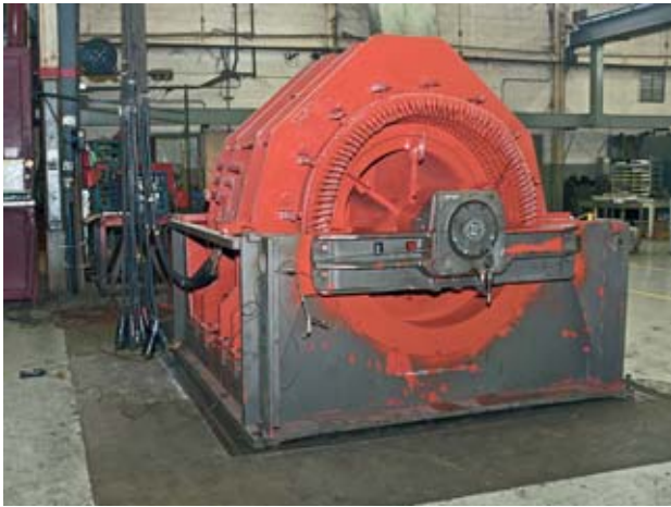
Bild 7: Ein für den letzten Testlauf auf dem Prüfstand vorbereiteter Motor
