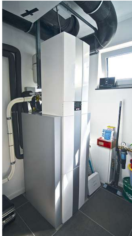
Bild 5: Im Heizungskeller aufgestellte Innereinheit der Split-Luft-Wasser-Wärmepumpe BWL-1S von Wolf
