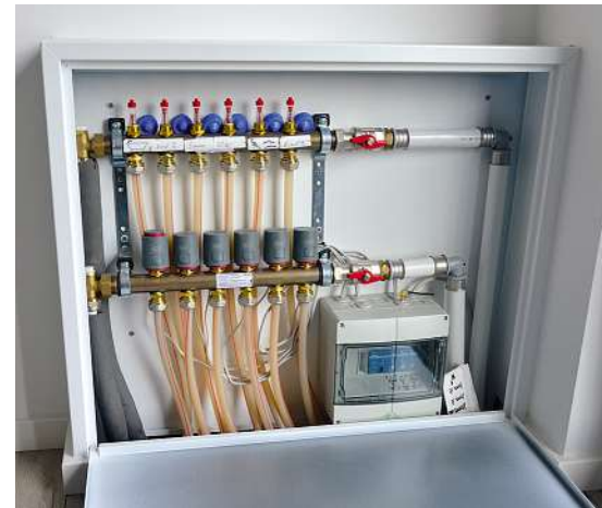
Bild 7: Der bidirektionale Fußbodenheizungsregler FAE14SSR steuert die Wärmeversorgung über die Flächenheizung
