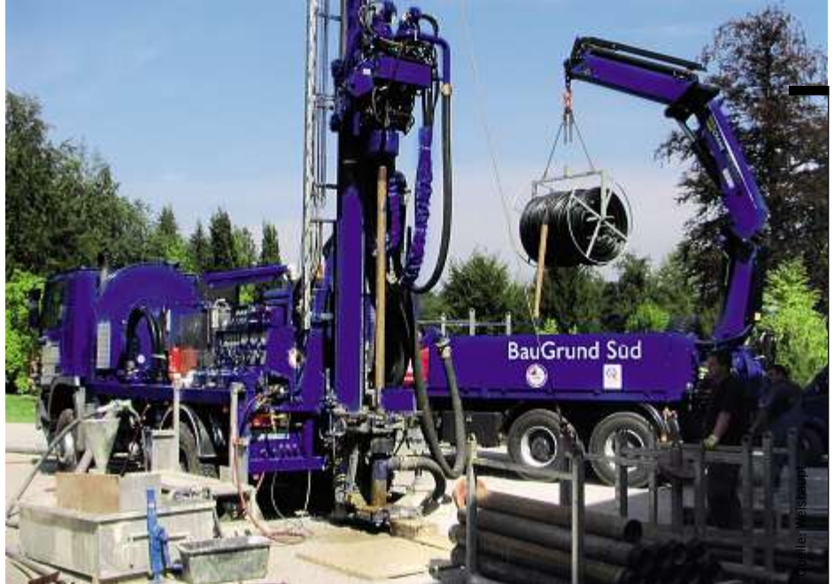
Bild 15: Tiefenbohrung für eine Erdwärmesonde: Weishaupt bietet mit seinem Bohrunternehmen Baugrund Süd die Bohrungen als komplettes Paket an
