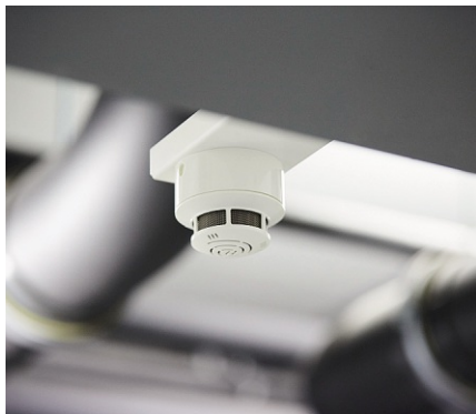
Bild 1: Muss regelmäßig getauscht werden: Rauchschalter einer Feststellanlage für Feuer-schutzabschlüsse
