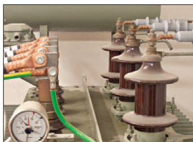
Bild 3: Offene Nieder- und Hochspannungsanschlüsse der Netztransformatoren
