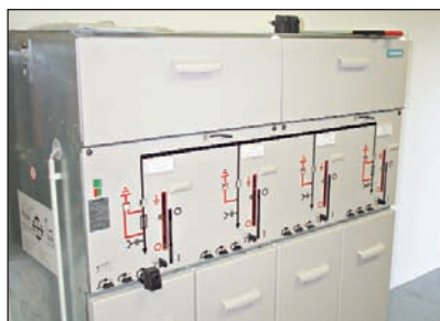
Bild 4: MS-Anlage in Blockbauweise
