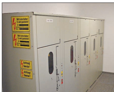
Bild 2: Typgeprüfte Schaltanlagen bieten eine hohe Personensicherheit
