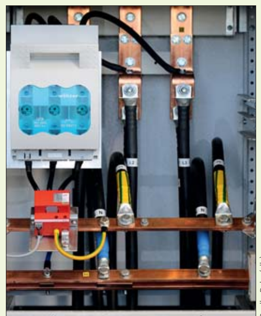
Bild 2: Hohe Sicherheit für nachgelagerte elektronische Anlagen und Systeme
