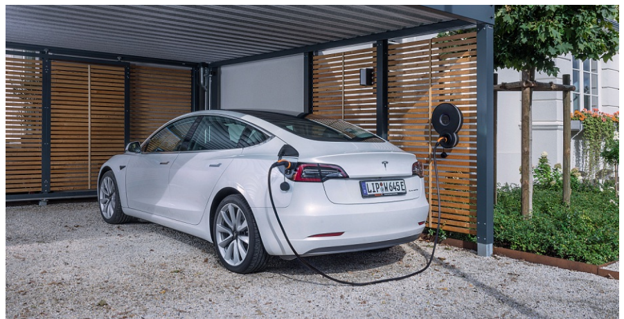
Bild 2: Ein Ring aus farbigen LED signalisiert den Zustand der Wallbox
