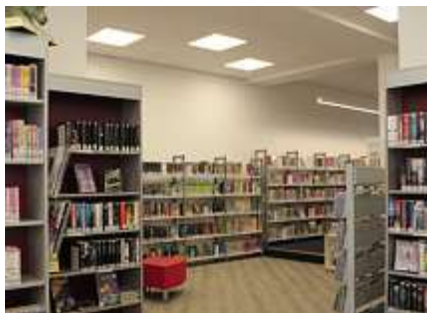
Bild 5: Die Bedienung der Beleuchtungsanlage erfolgt durch die Szenen-Steuerung aufgabengerichtet: unterschiedliche Lichtszenen stehen so für unterschiedliche Zwecke zur Verfügung und helfen beim Energiesparen
