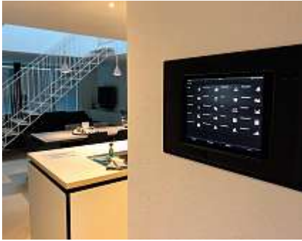
Bild 9: Die Visualisierung und Steuerung der KNX-Anlage erfolgt mit einem iPad (mobil oder in der Wandhalterung)
