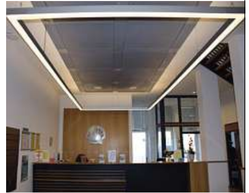
Bild 6: Die Rechteckkonstruktion mit der Leuchte SL789 LED von Performance in Lighting sorgt für die direkte/indirekte Beleuchtung der Hauptverkehrsflächen und ist Dali-dimmbar
