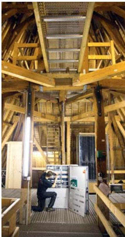
Bild 2: Im Dachgebälk stehen Leitungen oft im direkten Kontakt mit Materialien, die eine große Brandlast aufweisen
