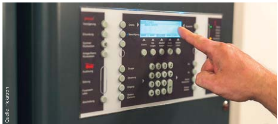
Bild 3: Vor-Ort-Einsätze an Brandmeldeanlagen können durch digitale Systeme reduziert werden
