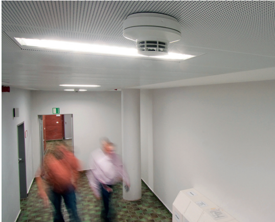
Bild 1: In Bürobereichen werden in der Regel Streulicht- oder Mehrfachsensormelder eingesetzt
