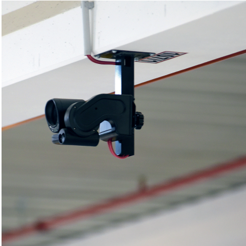
Bild 3: Hohe Hallen sind das ideale Einsatzgebiet für linienförmige Rauchmelder
