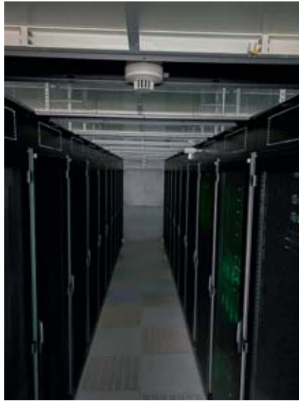
Bild 3: Maximale Sicherheit für einen kritischen Bereich: Das Rechenzentrum des ETP ist nicht nur gegen Brand und Einbruch gesichert, die Einbruchmeldeanlage berechtigt und protokolliert auch, wer die Räume betreten darf
