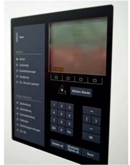
Bild 4: Acht miteinander vernetzte Brandmelderzentralen sind auf dem Gelände verteilt. Mittels Hauptmelder wird die Meldung im Brandfall automatisch an die Leitstelle der Feuerwehr übertragen
