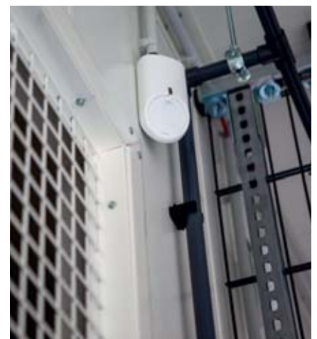
Bild 2: Zur Sicherheitslösung im ETP gehört auch eine Einbruchmeldeanlage. Viele dezent angebrachte Bewegungsmelder detektieren zuverlässig jeden unberechtigten Zutritt
