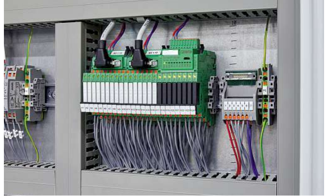
Bild 2: Übersichtliche Verdrahtung im Schaltschrank
