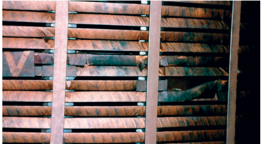
Bild 2: Einzelne Windungen einer Oberspannungswicklung sind aufgrund starker axialer Kräfte gegeneinander gekippt
