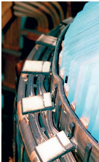
Bild 6: Vorschädigung einer Wicklung – radiale Verformungen an der Wicklung wie auch in axialer Richtung am Tragzylinder zwischen den Abstützungen der Spule
