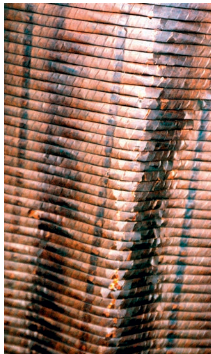
Bild 3: Unterspannungspule mit verformter Wicklung durch radiale Kurzschlusskräfte
