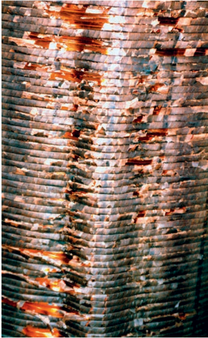
Bild 4: Nach einer Kurzschlussbelastung sank der sog. DP-Grad der Papierisolation erheblich
