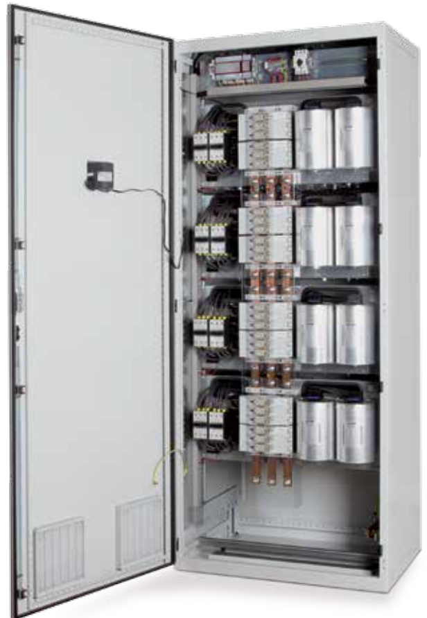
Bild 9: Blindleistungkompensationsanlage im Standschrank
